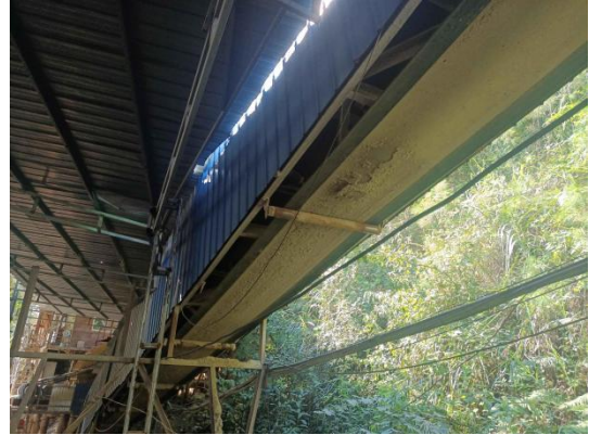
已封闭的输送皮带
