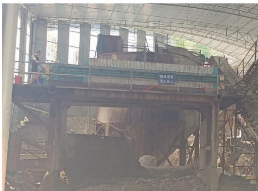
废水处理系统板框压滤机
