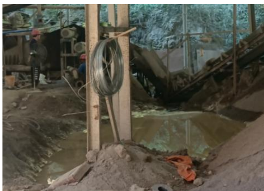
生产车间废水收集池
