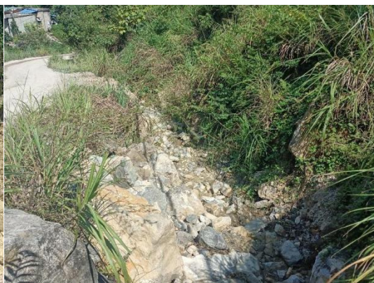
已建设的雨水收集沟
