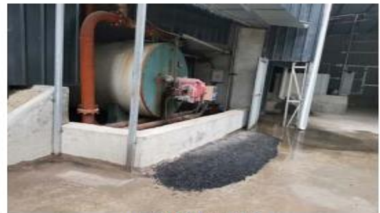
导热油锅炉围堰
