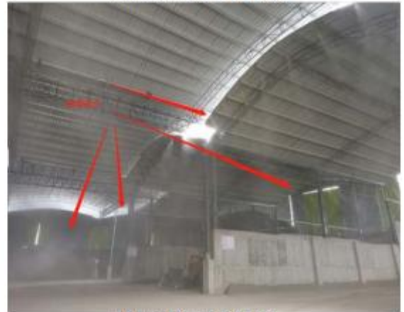
料棚封闭+喷雾喷头
