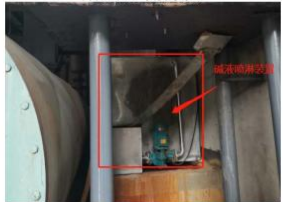
导热油锅炉碱液喷淋装置
