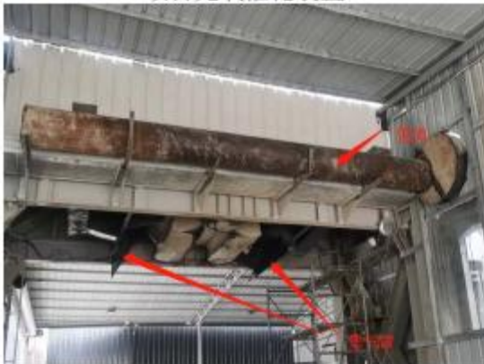
项目沥青卸料口封闭+废气
