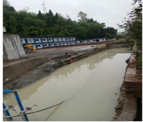
车辆冲洗沉淀池
