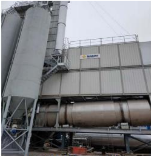
沥青搅拌站楼布袋除尘装置
